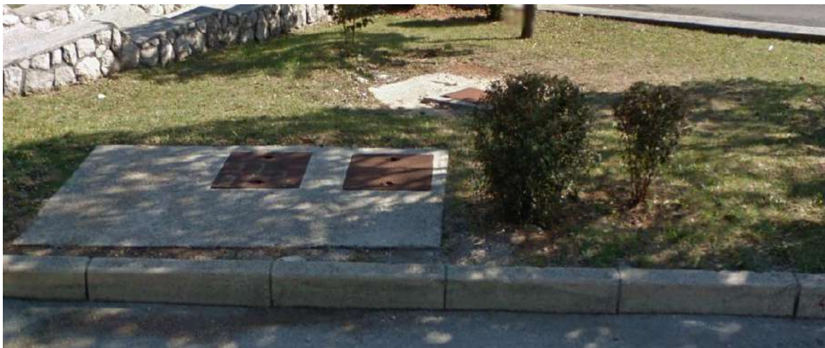
Fotografija 3: Postojeći sustav odvodnje – Postojeća (zatrana) upojna građevina
