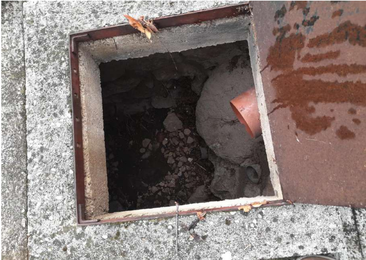
Fotografija 2: Postojeći sustav odvodnje – Postojeća (zatrana) upojna građevina
